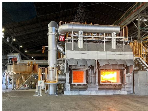
四国製造所 アルミリサイクル炉
